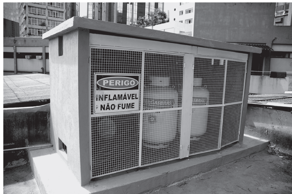
Veja como ficou a central de gás da Aslemg após o término das obras
